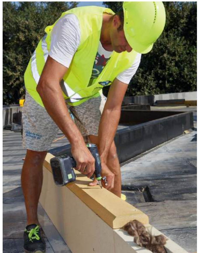
▼ In die Hohlräume zwischen den Metallstützen wurde Mineralwolle eingebracht und der Aufbau mit einem Deckel geschlossen
