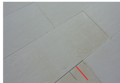
Slika 6: Primer slabo zatesnjenih stikov
